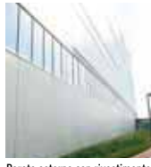
Parete esterna con rivestimento fotovoltaico "Kaze-Kamome"
